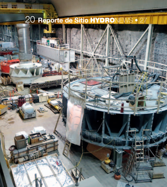
Caverna de Máquinas
