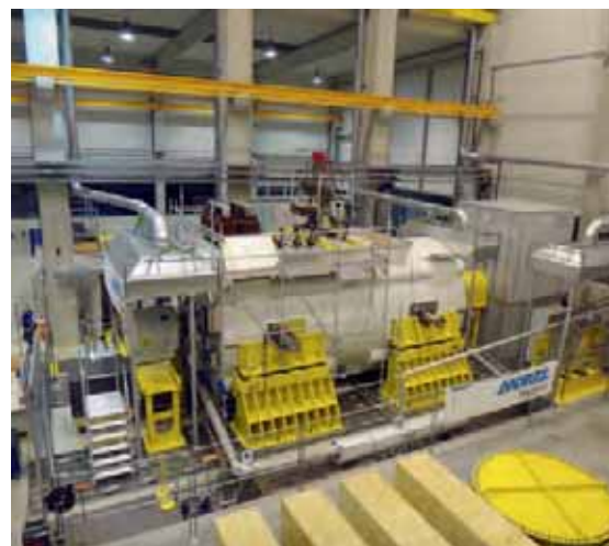
Turbo-alternateur à refroidissement à hydrogène sur le bac d'essai
