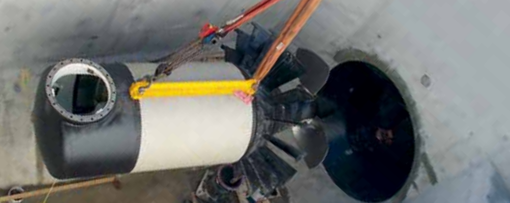
Installation d'un ECOBulb™ dans la centrale
