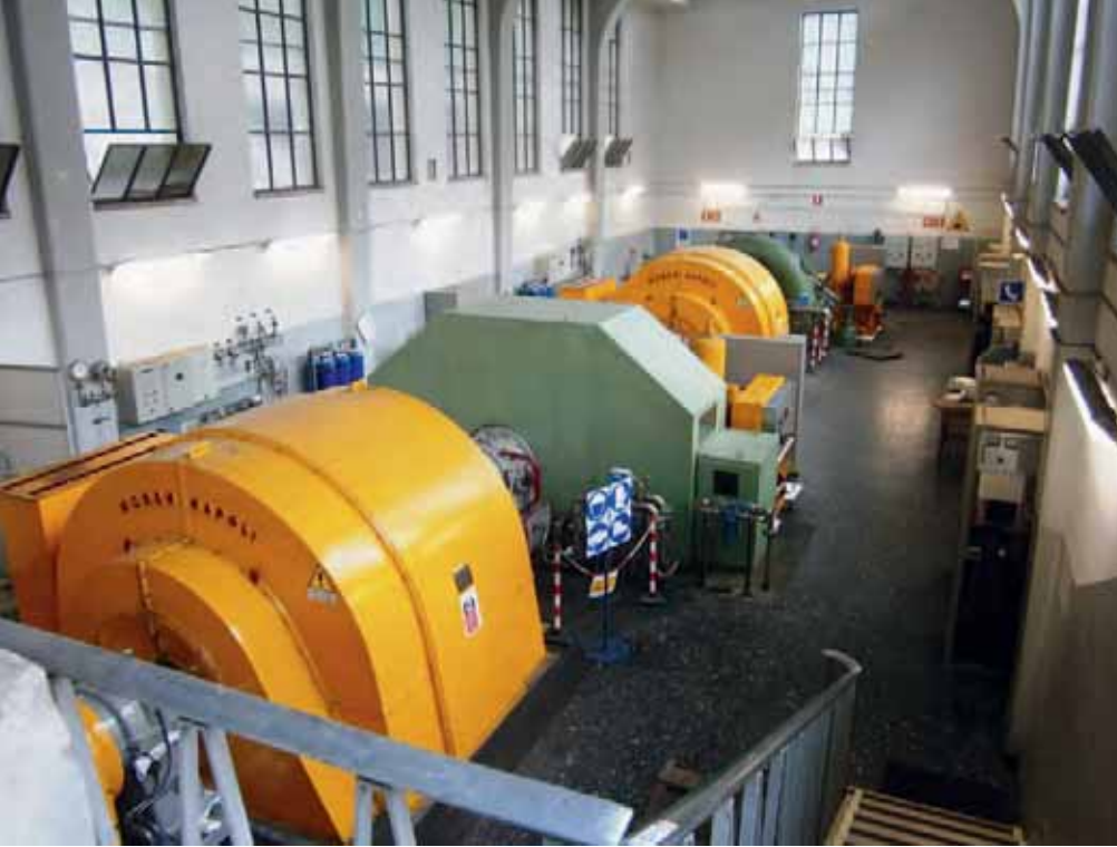
La salle des machines
