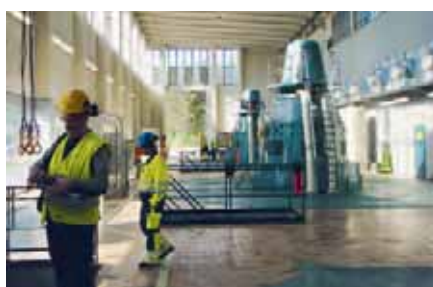
▣ La salle des machines de Bjurfors Övre
