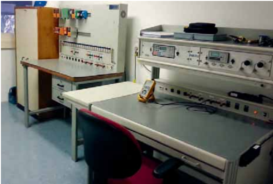
▫ Banc d'essai pour l'instrumentation, PLC et réseau de communication
